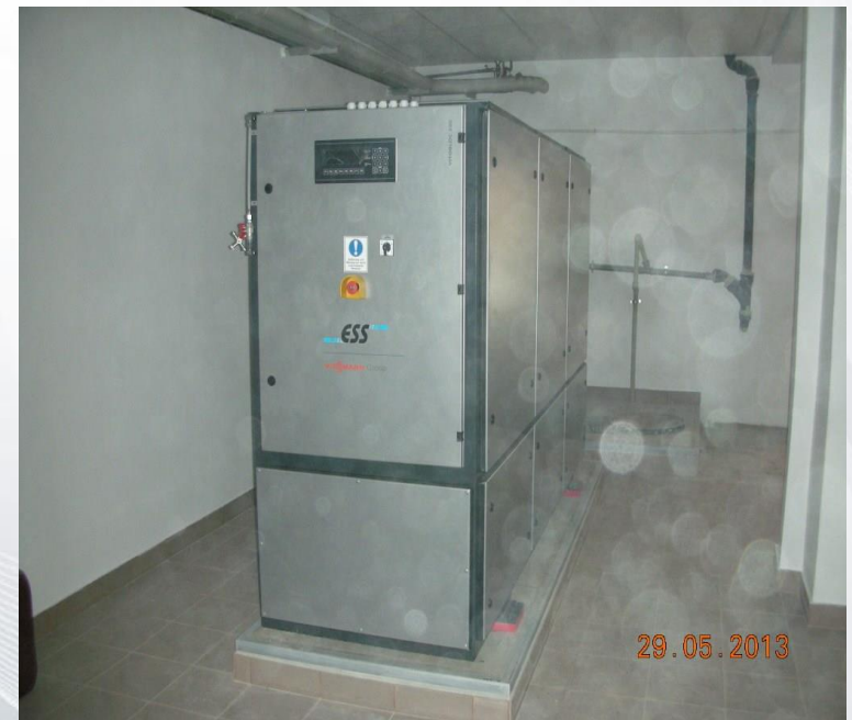
Agregat kogeneracyjny 55kW zainstalowany w mini centrum Paniówki
