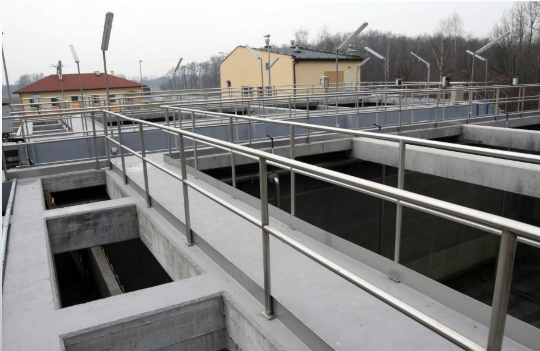
Oczyszczalnia ścieków w gminie Gierałtowie w Przyszowicach o wydajności 2150\text{m}^3 /dobę (uruchomiono sierpień 2015)
